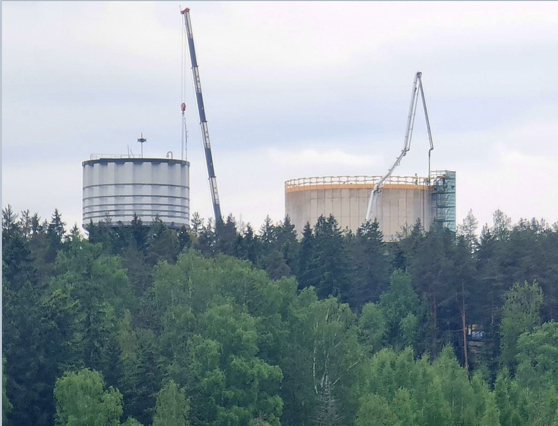
Klaukkalan vesitornit Kuva: Nurmijärven Vesi
