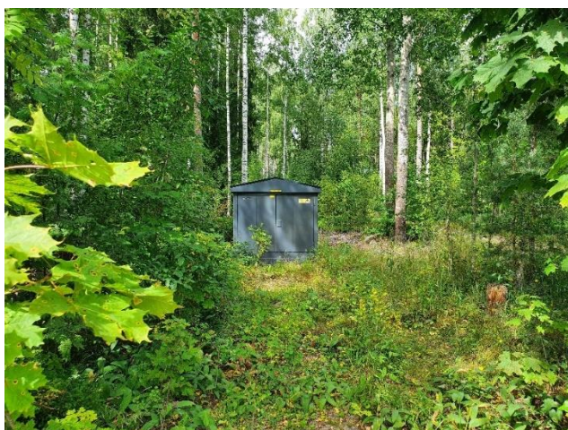
Kuva 15-1. Puistomuuntamo Nummenpään pohjavesialueella.
