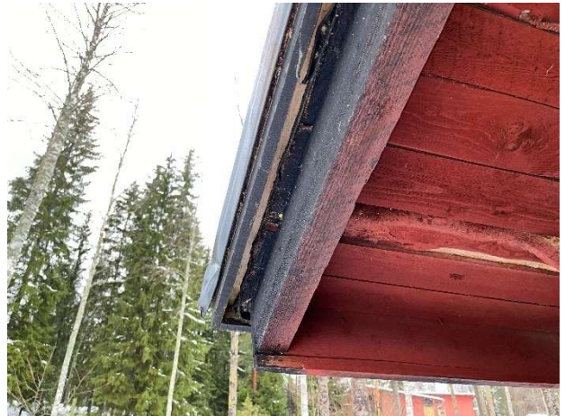
Kuva 179. Räystäsrakenteita. Paikoin räystäiden aluslaudoissa oli pieniä lahovaurioita.
