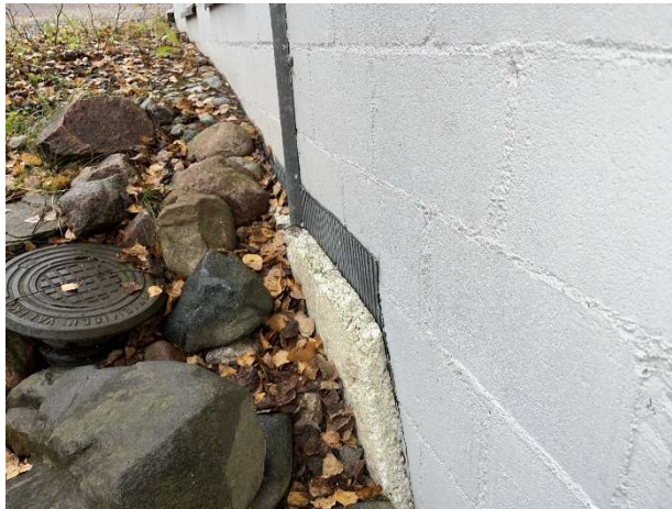
Kuva 76. Kellarikerroksen ulkopuolinen vedeneristys on puutteellinen.
