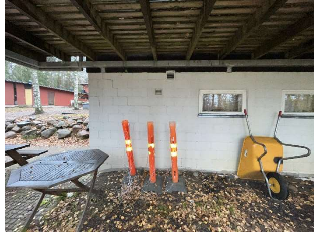
Kuva 75. Kellarikerroksen ulkoseinärakenteessa havaittiin paikoin halkeamia.
