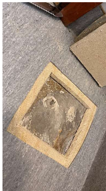
Kuva 64. Betonilaatan päällä on vanhat tasoitteet ja mattoliimoja.
