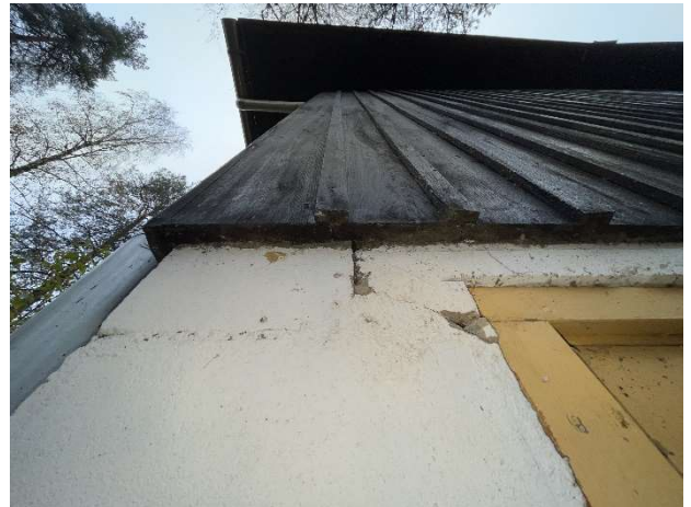
Kuva 73. Harkkomuurauksen ja puuverhouksen välissä ei havaittu tuuletusrakoa.
