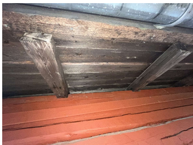
Kuva 144. Järven puoleisella pitkällä sivulla ilmarako ulkoseinän ja räystäsrakenteiden välillä on n iukka.
