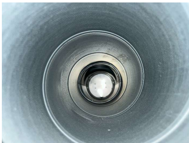
Kuva 45. Tuloilmakanavat olivat aistinvaraisesti arvioituna puhtaat.
