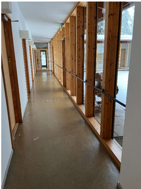
Kuva 9. Käytävillä ei ole muovimattoja.
