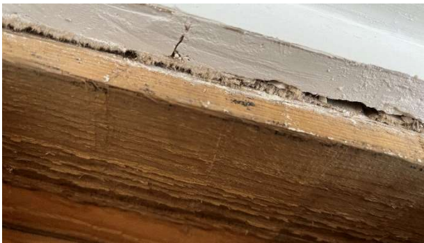
Kuva 39. Silminnäkävää mikrobikasvua kipsilevyn sisällä.
