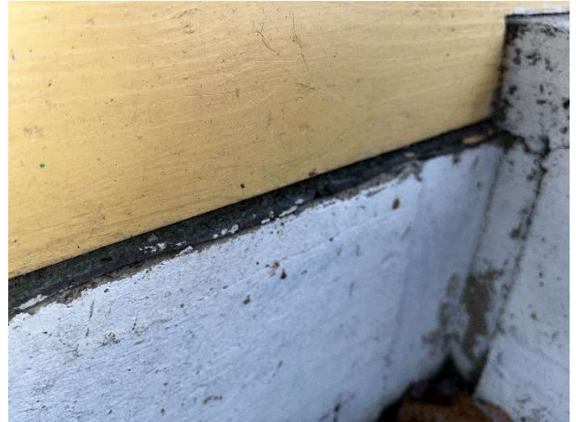
Kuva 71. Pääsisääkäynnin puolella paikalla valetun sokkelin ja ulkoseinärakenteen välissä havaittiin bitumikermi.
