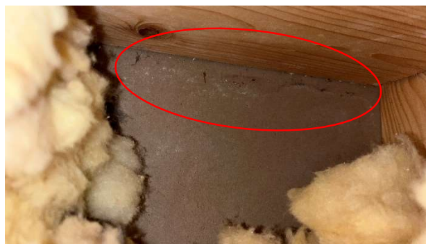
Kuva 30. Tummumaa ikkunan alapuolisen seinärakenteen tuulensuojalevyssä.
