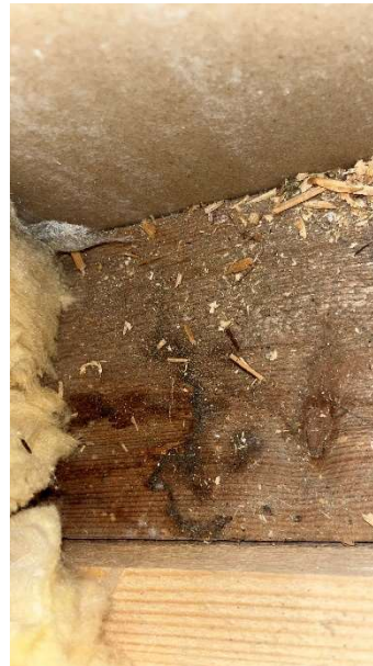
Kuva 94. Ulkoseinäavauksessa kosteusjälkiä alaohjauspuussa.
