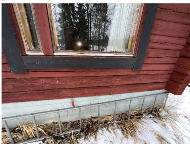
Kuva 168. Pesuhuoneen alueella ulkoseinähirressä havaittiin pieniä lahovaurioita.
