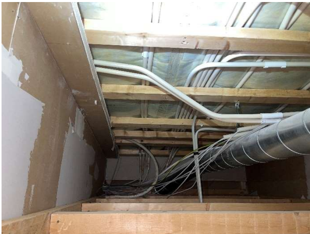
Kuva 41. Laskettujen kattojen päällä oli hieman pölyistä ja samalla havaittiin myös hiirten jätöksiä.
