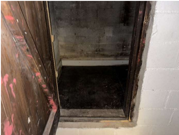
Kuva 98. Porraskäytävän takana on varastotila, jonka ilma on melko kostea.
