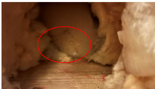
Kuva 29. Tummumaa ikkunan alapuolisen seinärakenteen tuulensuojalevyssä.
