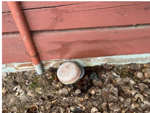
Kuva 161. Alapohjan tuuletusputken kautta tuleva kosteus rasittaa hirsiseinää.
