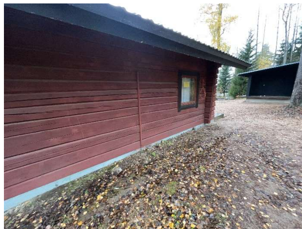
Kuva 155. Rakennuksen vierustaa. Maanpinta viettää kohti rakennusta.
