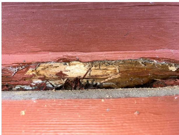
Kuva 127. Ulkoseinän hirsirakenteessa havaittiin paikoin isoja rakoja ja pieniä lahovaurioita.
