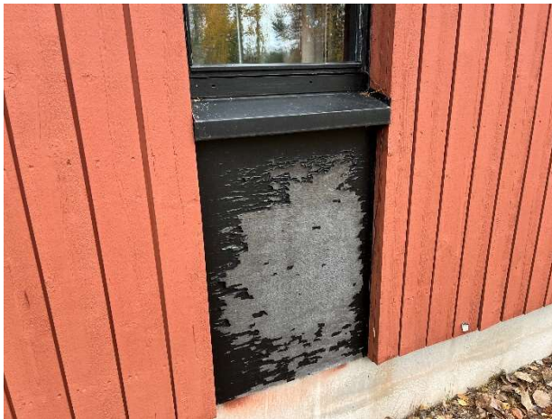
Kuva 19. Ikkunan alle on kohdistunut selvää kosteusrasitusta. Kohdalle tehtiin seinän alaosaan rakenneavaus majoitusrakennus US3
