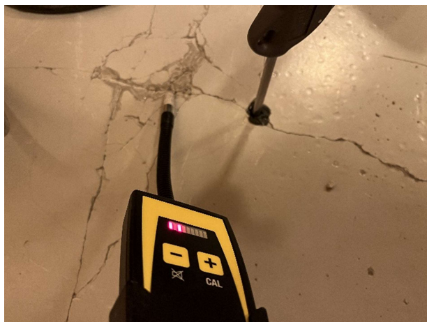
Kuva 56. Halkeamien kautta havaittiin ilmavuotoa.
