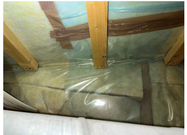
Kuva 42. Höyrynsulut on teipattu pakkausteipillä. Teipit olivat vielä pääasiassa kiinni, Paikoitellen teippaukset olivat aistinvaraisesti arvioituna epätiiväitä.
