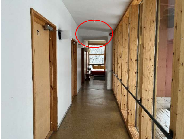
Kuva 37. Käytävällä tiedettiin olevan vanha kosteusvaurio.
