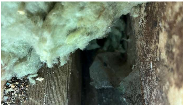
Kuva 172. WC:n puoleinen levy pinta hyvin tumma.
