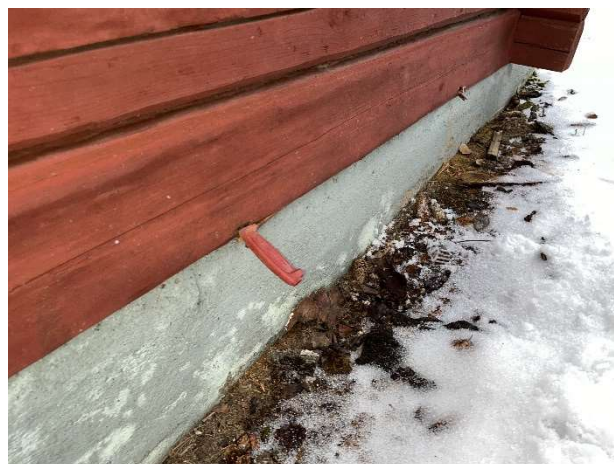
Kuva 163. Alimmassa hirressä havaittiin lahoa.
