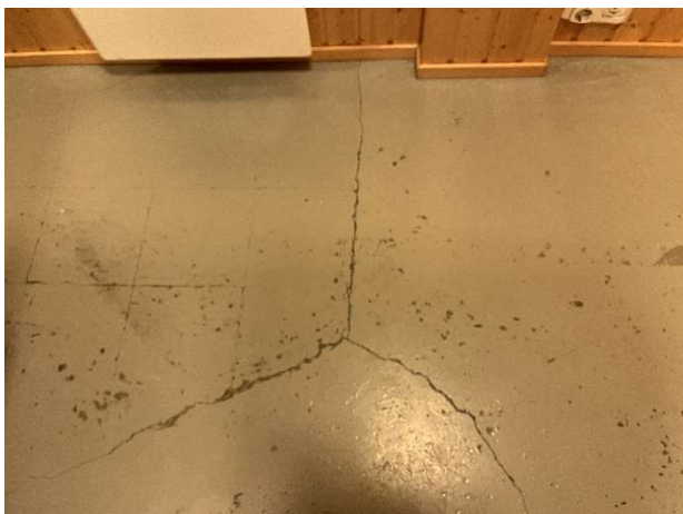
Kuva 55. Betonilaatassa havaittiin halkeamia.
