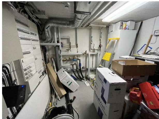
Kuva 68. Teknisen tilan "väliseinä", nykyinen maanvastainen seinä, on kosteusvaurioitunut.
