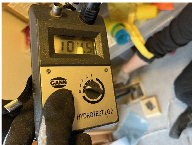
Kuva 61. Toimiston betonilattian pintakosteusarvot olivat koholla.
