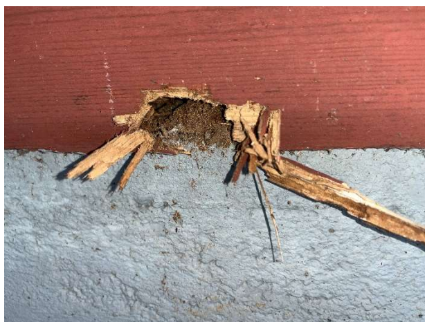
Kuva 164. Alimmassa hirressä havaittiin lahoa. Lahovaurio on edennyt jo melko pitkälle.
