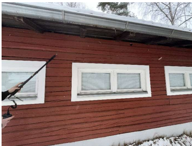
Kuva 125. Hirsirunko on painunut yläosastaan hieman järven puoleisella pitkällä sivulla.
