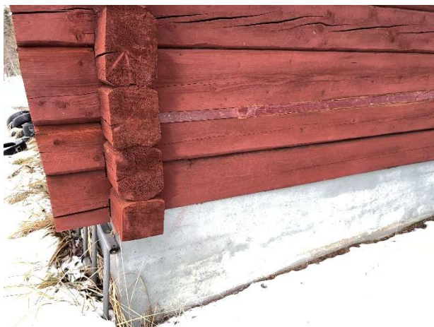
Kuva 166. Hirsien rakoja on paikoin tilkitty puurimoilla.
