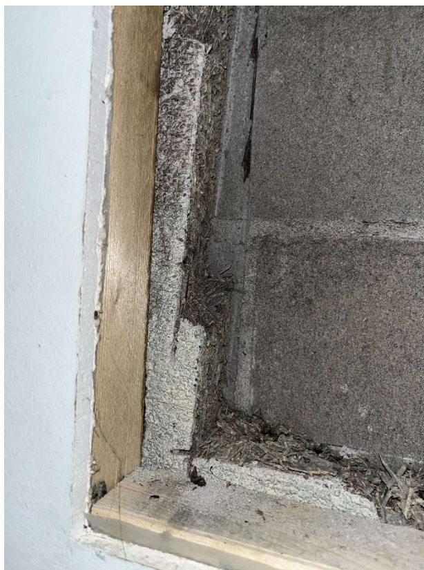
Kuva 97. Rakenneavaus US7. Rakenteessa havaittiin kosteudelle herkkää tojalevyä.
