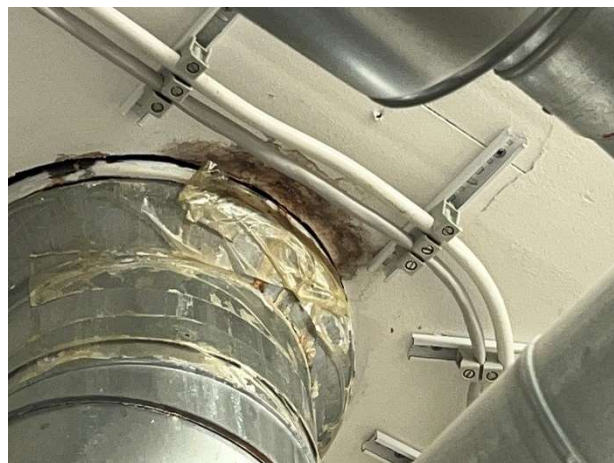
Kuva 44. IV-konehuoneen läpiviennin kohdalla jälkiä kosteusvauriosta. Arviolta läpivienti on vuotanut.
