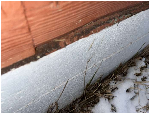
Kuva 123. Hirsirungon ja sokkelin välissä havaittiin bitumikermi.
