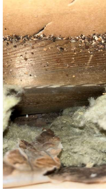
Kuva 171. Kuva rakenneavauksesta. Eristetilassa oli mikrobiperäinen haju.
