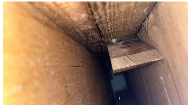
Kuva 40. Kotelossa selvää mikrobikasvua sekä puurakenteissa että kipsilevyn taustapahveissa.
