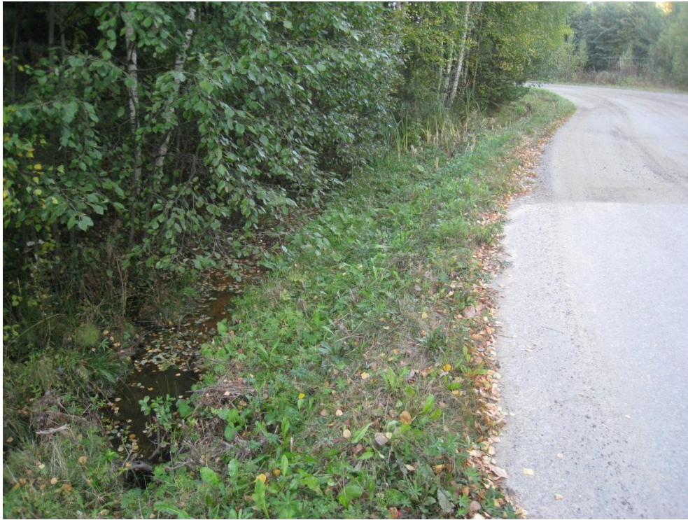
Kuva 8. 500M hulevesiviemäri purkaa alueen hulevedet Ojamäentien sivuojaan
