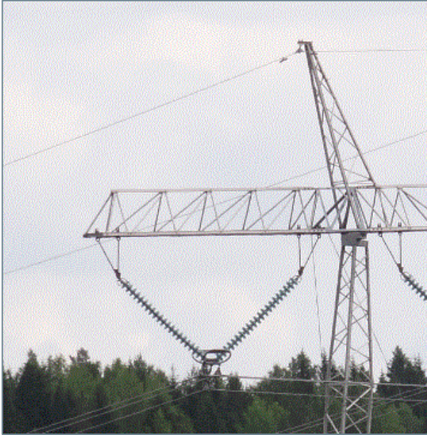
Kuva 6-8. Voimajohtopylvään eristimiä, joissa koronapurkauksia voi esiintyä.
