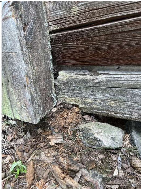
Kuva 27 Alimmat ulkoseinähirret ovat osin maata vasten.
