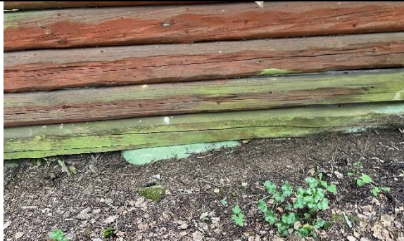
Kuva 50 Alimmat ulkoseinähirret on osin maata vasten.
