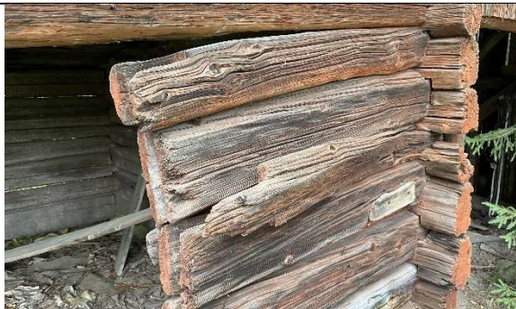
Kuva 52 Ulkoseinähirret ovat vaurioituneet.
