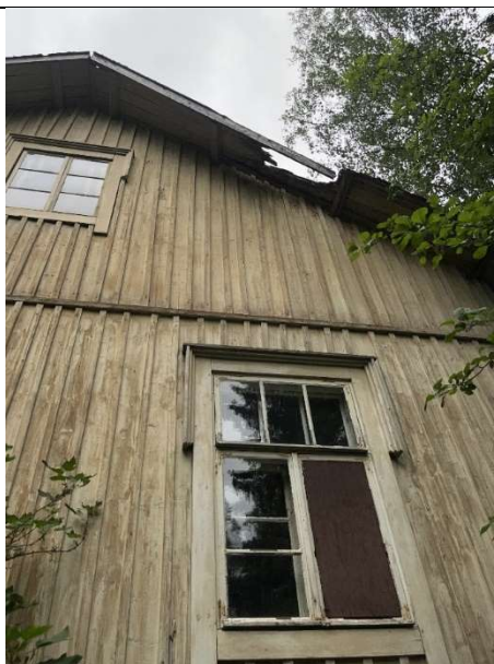
Kuva 17 Räystäät ovat paikoin lahot.
