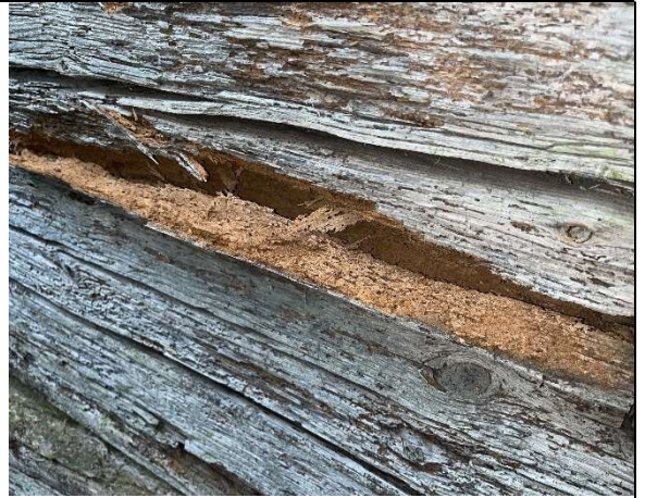
Kuva 46 Ulkoseinäverhouksessa havaittiin laajoja lahovaurioita.
