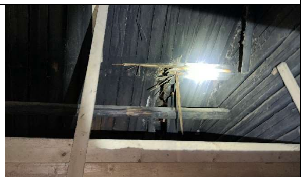
Kuva 44 Vesikatto on paikoin vaurioitunut.
