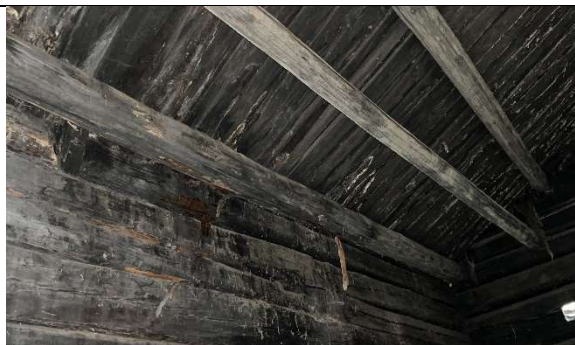
Kuva 41 Kosteus- ja lahovaurioita yläpohjassa ja ulkoseinärakenteissa.
