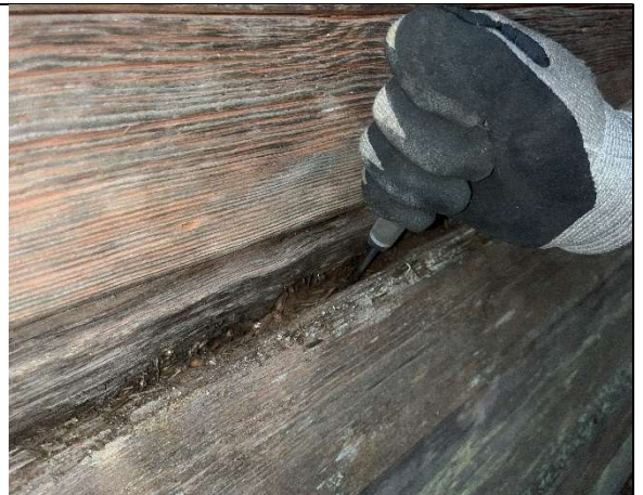
Kuva 28 Ulkoseinähirsissä havaittiin lahovaurioita.
