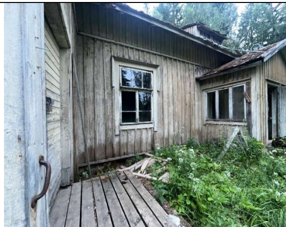
Kuva 9 Sisäänkäynnin puoleinen julkisivu on osittain pullahtanut ulospäin
