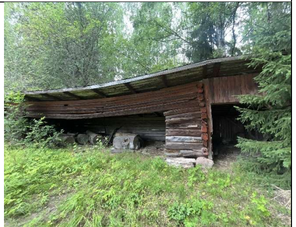
Kuva 53 Rakennuksessa on romahdusvaara.
