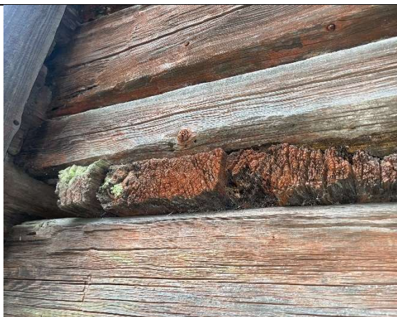
Kuva 29 Välipohjalaudoituksessa havaittiin lahovaurioita.
