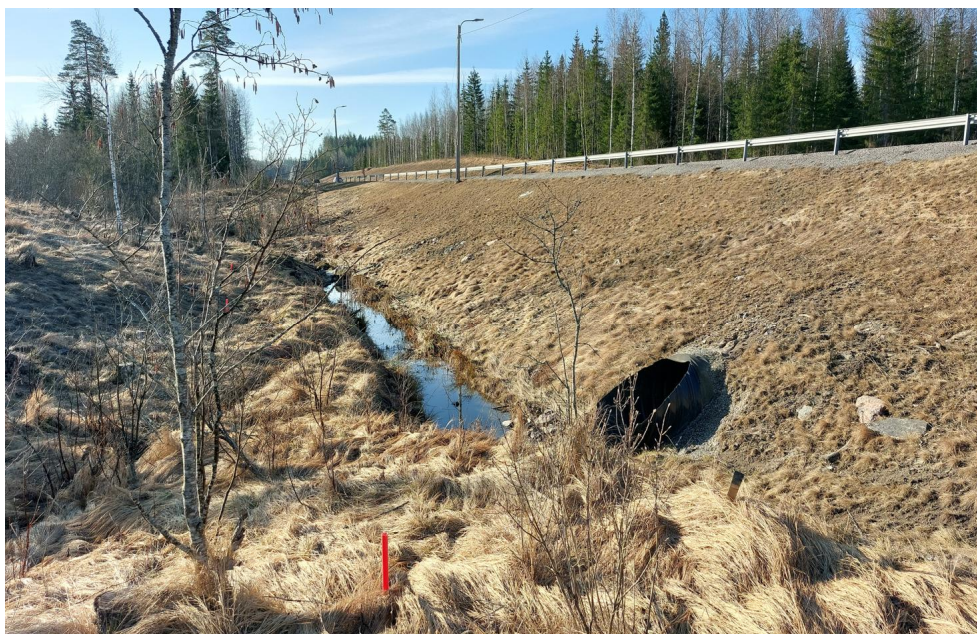
Kuva 16. Klaukkalan kehätien alittava 1600 mm rumpu. 800 mm betonirumpu jää kuvassa oikealle ja on teräsrumpua huomattavasti korkeammalla. [Ramboll 4/2025]
