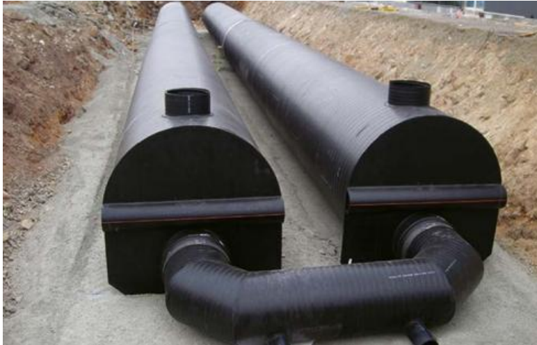
Kuva 19. Esimerkki tonttikohtaisesta suuremman mittaluokan hulevesisäiliöstä hulevesien viivytykseen ja varastointiin [Weholite, Uponor Oyj].
