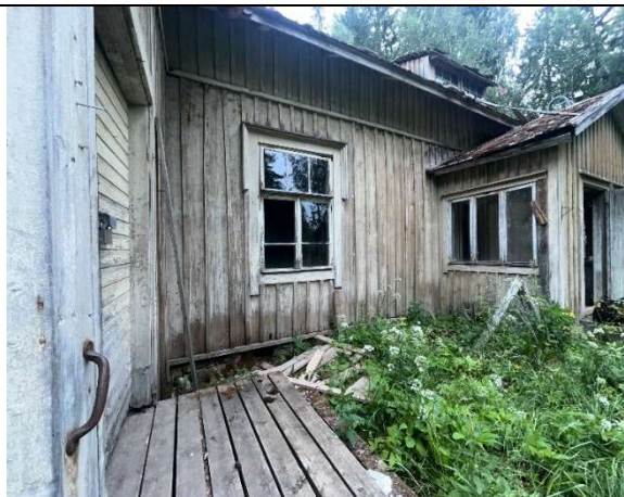
Kuva 9 Sisäänkäynnin puoleinen julkisivu on osittain pullahtanut ulospäin
