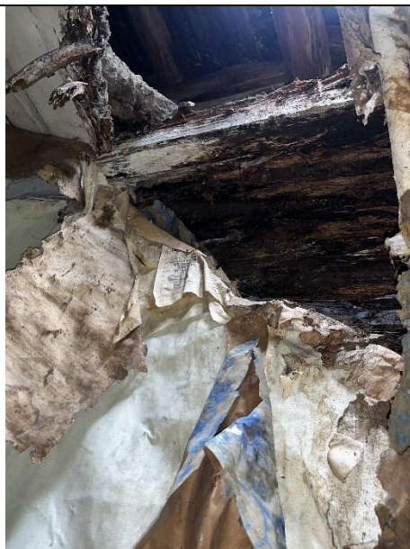
Kuva 22 Kosteus- ja lahovaurioita välipohjassa ja yläpohjassa.
