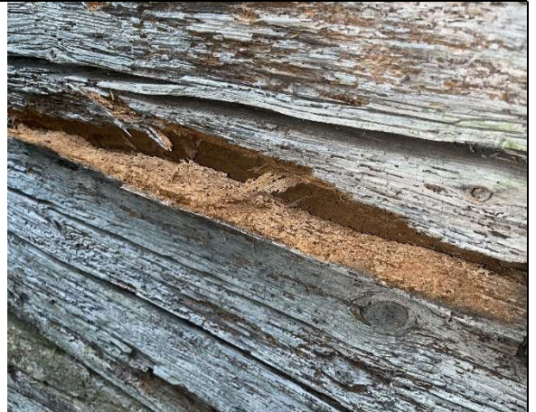
Kuva 46 Ulkoseinäverhouksessa havaittiin laajoja lahovaurioita.
