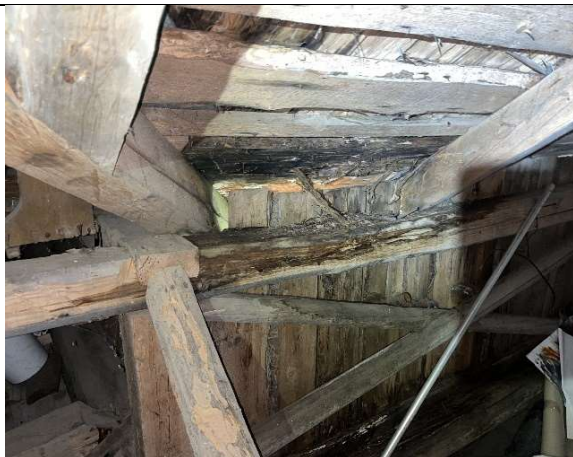
Kuva 5 Kosteus- ja lahovaurioita yläpohjassa ja ulkoseinärakenteissa.
