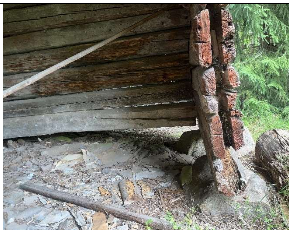
Kuva 54 Rakenteet ovat pettäneet.
