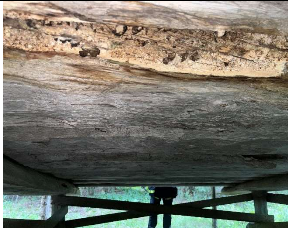
Kuva 36 Kosteus- ja mikrobivaurioita alapohjarakenteissa.
