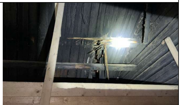
Kuva 44 Vesikatto on paikoin vaurioitunut.
