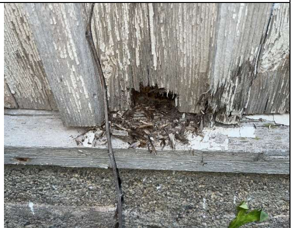
Kuva 10 Ulkoseinäverhouksessa havaittiin laajoja lahovaurioita.
