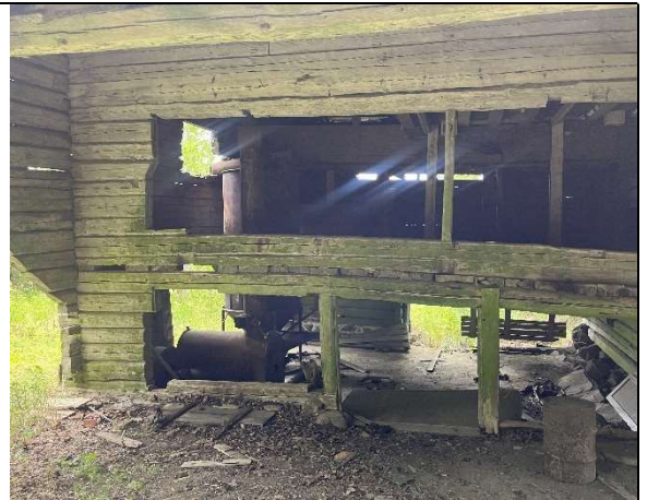
Kuva 40 Etuosan ulkoseinähirret ovat notkolla.
