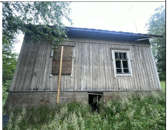
Kuva 12 Sokkeli on paikoin korkea.
