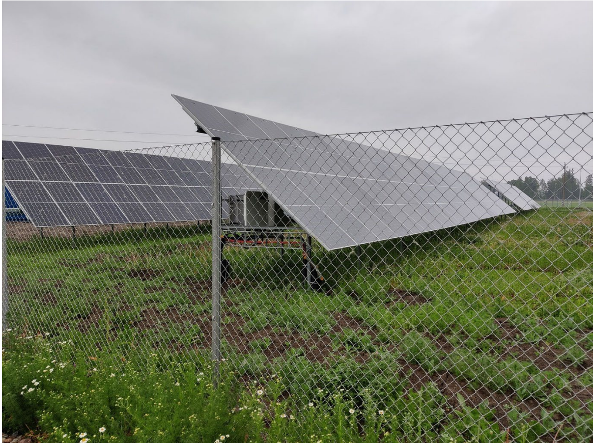
Kuva 17: Esimerkki aurinkopaneeleista perustettuna peltoalueelle. Kuva hankealueen läheisyydessä sijaitsevalta Helen Oy:n aurinkovoimala-alueelta (Arkkitehtitoimisto Ajak Oy).
